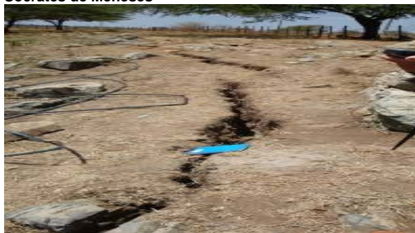
Figura 2 – Desenvolvimento da rachadura na superfície do terreno na área do Sr. Gildásio S. Paiva.
