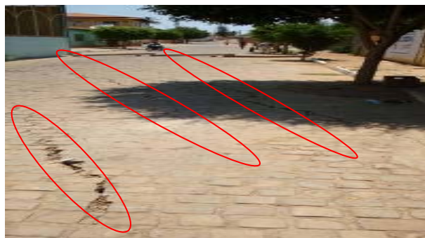
Figura 1-Vista das rachaduras no calçamento da rua Sócrates de Meneses
