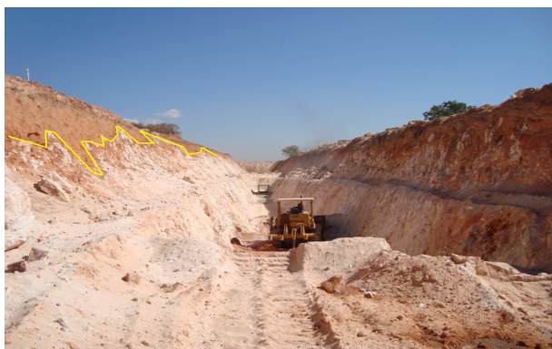
Figura 2: Fotografia evidencia uma escavação para a instalação da rede de drenagem pluvial do Setor Noroeste que atingiu o pacote de quartzito. A linha amarela mostra a irregularidade do topo rochoso.
