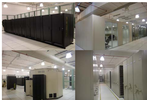
Figura 5 – Instalações do Centro de Mídia Digital de E&P – CMD, área operacional onde são gerenciados todos os dados sísmicos da Petrobras.
