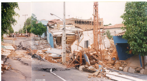
Figura 1 – Foto evidencia o colapso do terreno causado pela perfuração percursiva na rua Simplicio Mendes, Teresina, PI, no ano de 1999.
