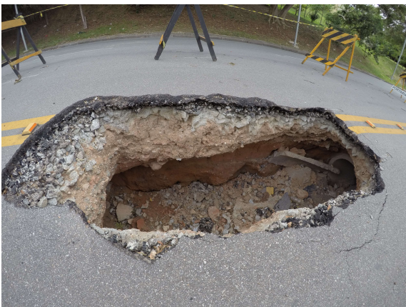
Figura 1 – Vista do buraco aberto no centro da avenida.
