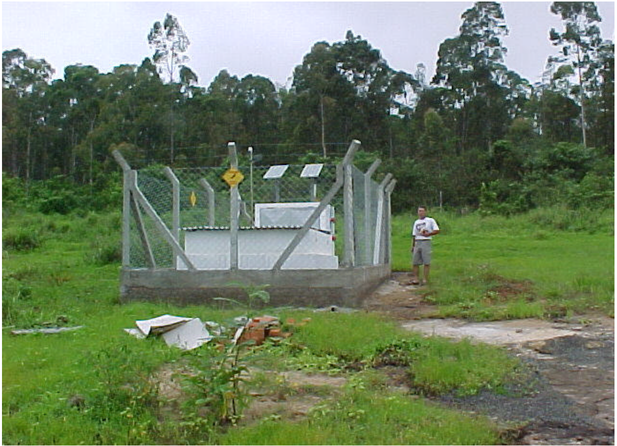
Figura 4: Local das Instalações da Estação Sismológica RCLB.
