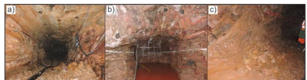
Figura 4 - Fotos da água nas faces de desenvolvimento A, B e C. Em a) localizada no plano inclinado, b) grande quantidade de água na galeria e c) água na rampa de acesso das galerias. Adaptado de Mineração Curral de Pedra, 2017.
