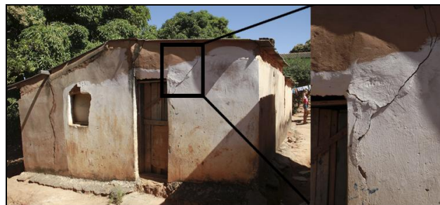
Figura 1 – Imagem da casa interditada pela Defesa Civil no Bairro Vila Atlântida.
