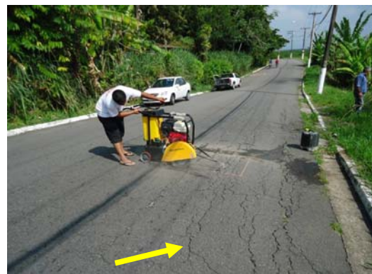
Figura 3 - Início da abertura da cava (corte do revestimento com serra) na estaca 12. Observar as trincas no pavimento da rua (seta amarela).
